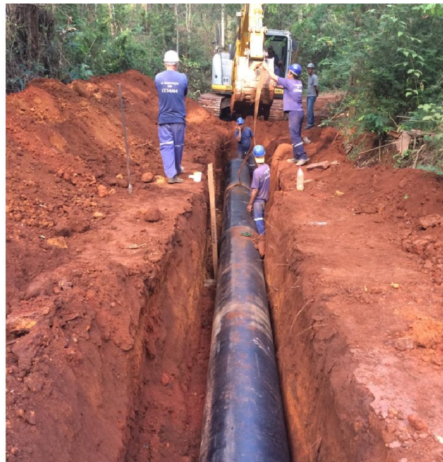
Implantação da Adutora na Av. Eudócio Infante Vieira (Estrada Velha da Represa).
